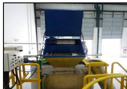
FOTOGRAFÍA 3 - TOLVA UTILIZADA PARA LA ADICIÓN DE LA MATERIA PRIMA EN POLVO. AL INTERIOR SE PUEDE OBSERVAR EL FILTRO
